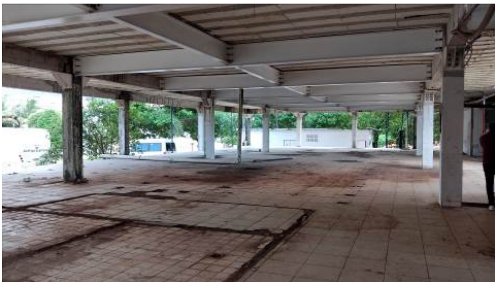
Foto 8 – Área administrativa piso térreo – paredes de alvenaria a reconstruir e piso a demolir
