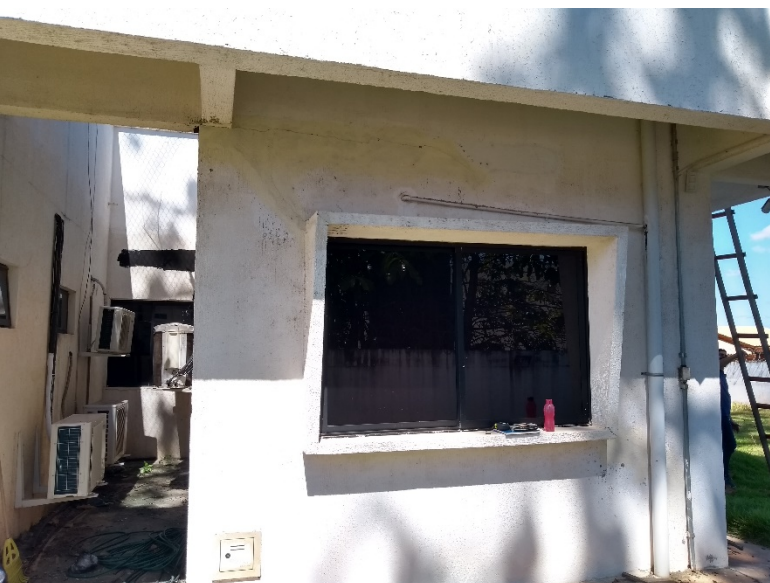
Imagem 3: Registro de alvenaria com presença de tratamentos de fissuras e trincas.
