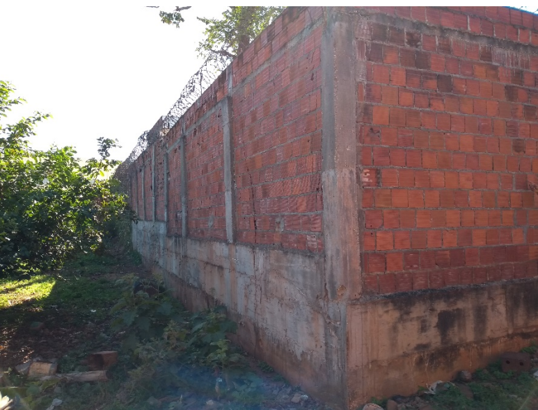
Imagem 7: Vista externa da contenção com registro de trincas na alvenaria e elementos de concreto.
