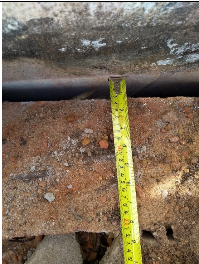
Imagem 9: Deslocamento da contenção – 30 mm.
