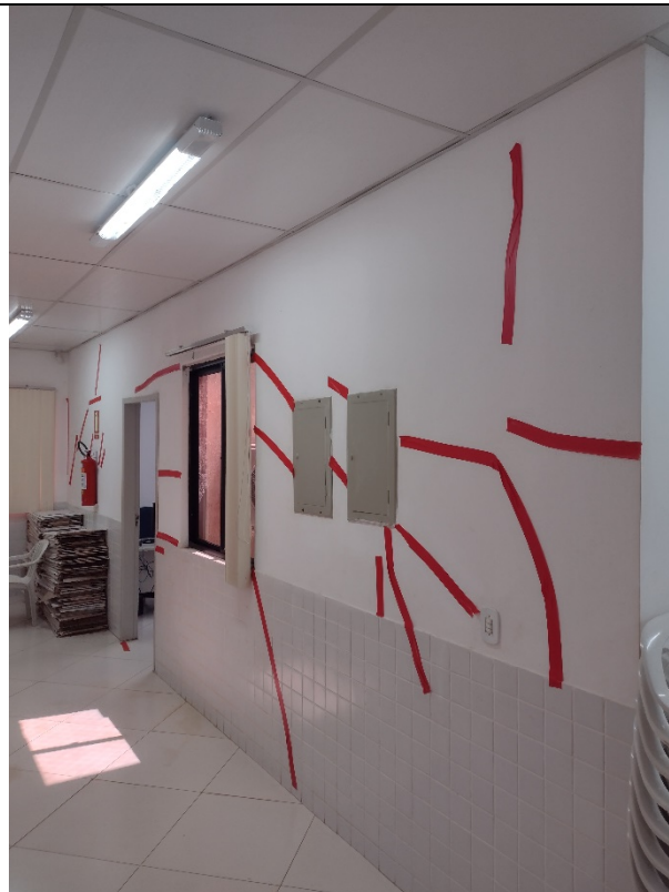
Imagem 2: Corredor interno com ampliação das quantidades de fissuras e trincas nos painéis de alvenaria.
