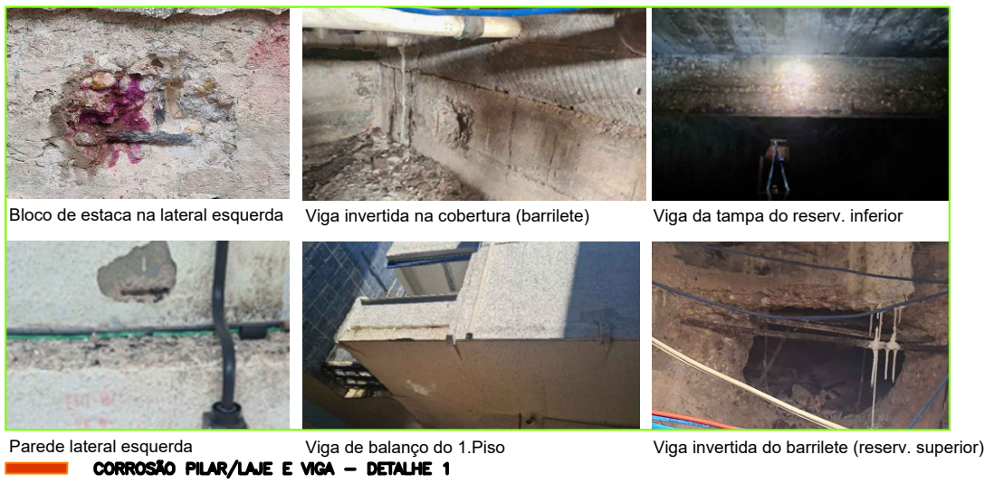
CORROSAO PILAR/LAJE E VIGA - DETALHE 1
