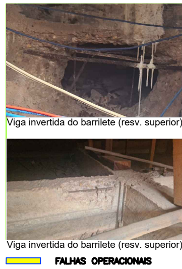
FALHAS OPERACIONAIS - DETALHE 2
