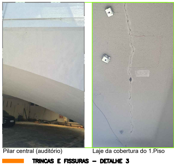
TRINCAS E FISSURAS - DETALHE 3
