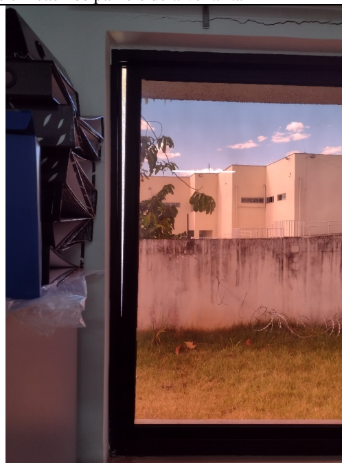
Imagem 4: Desaprumo da esquadria e fissuras e trincas diversas.
