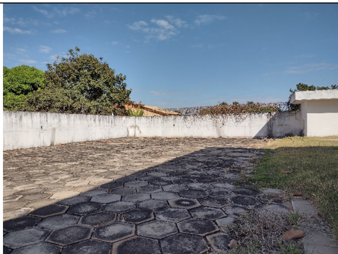
Imagem 6: Área externa com registro de acomodação do pavimento próximo à contenção.
