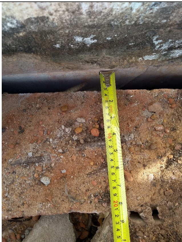
Imagem 9: Deslocamento da contenção – 30 mm.
