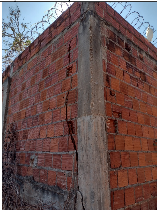
Imagem 8: Vista externa da contenção com aumento das dimensões das trincas/rachaduras.
